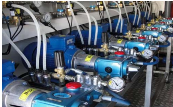
Rys.10. System pompowy myjni [11]
