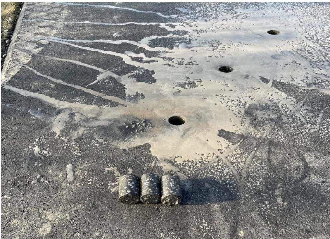
Рисунок 4 – Відібрані зразки-керна на під'їзній автомобільній дорозі до прохідної 1-го блоку ДТЕК Бурштинської ТЕС Figure 4 – Selected core samples on the access road to the passageway of the 1st block of DTEK of the Burshtyn TPP
