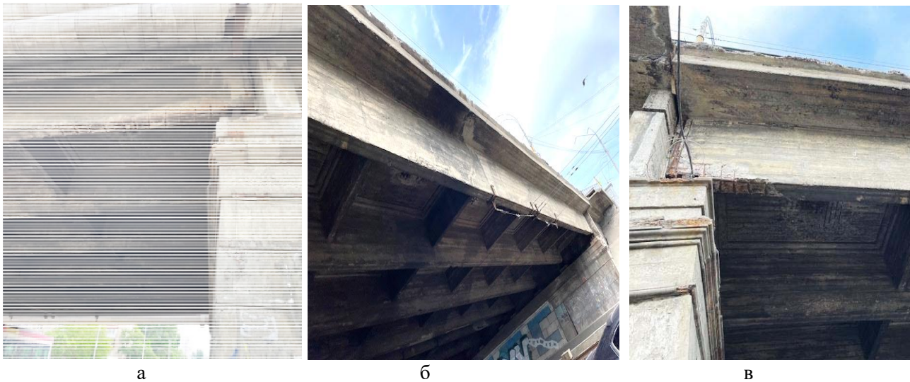
а б в Рисунок 1 – Загальний вигляд пошкоджень мосту Повітрофлотського проспекту через р. Либідь в м. Київ Figure 1 – General view of the damage to the Povitroflotskyi Avenue bridge across the Lybid River in Kyiv
